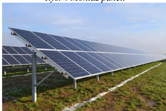
Rys. 5a Gotowa instalacja (układ na południe)
